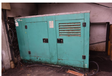
Le Groupe électrogène installé
